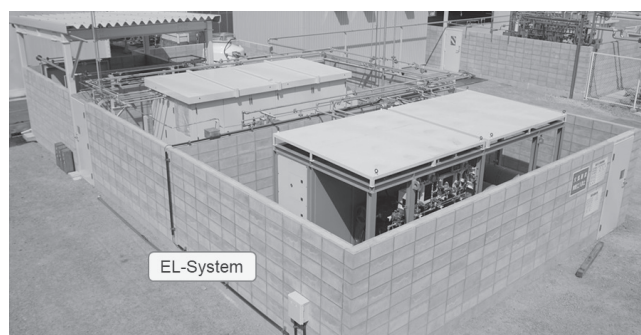
図2 水電解システムの外観（神戸製鋼所 高砂製作所内） 7) Fig.2 Outlook of EL-System (in Kobe Steel Takasago Works).
